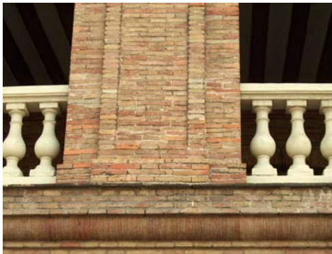
IMAGEN 17: Detalle de los aparejos de la fachada. Plaza de Toros de Valencia.
